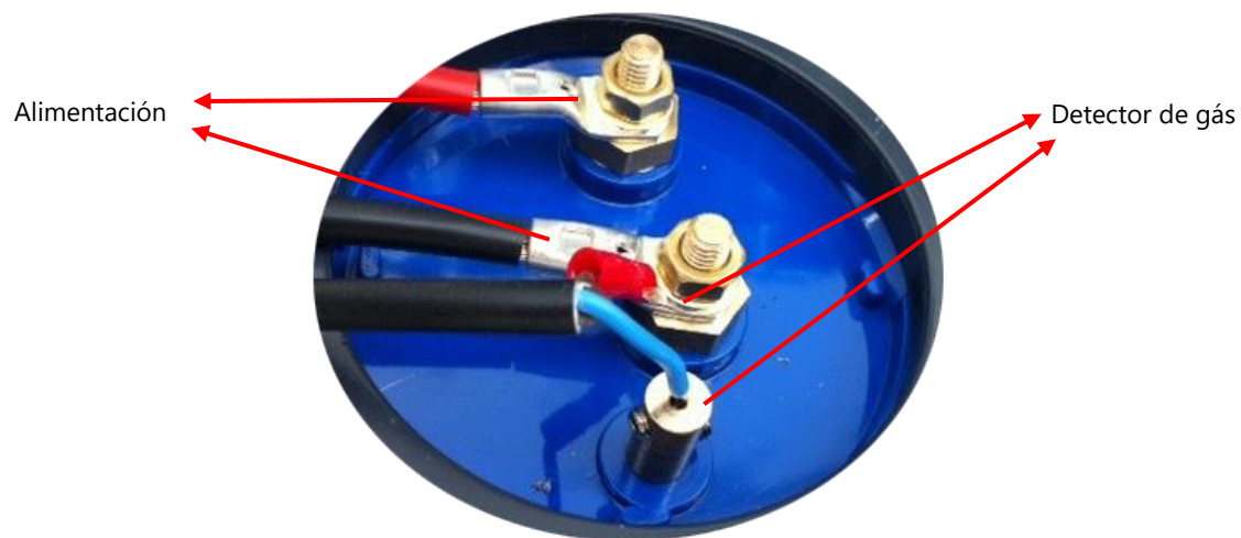
Figura 5 – Terminales de Conexión en la Celda
